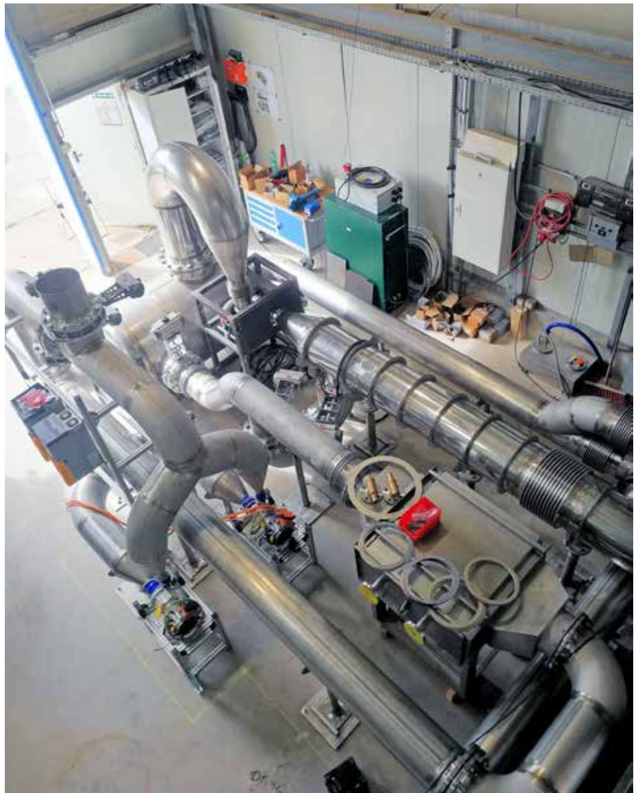
Der zu Forschungszwecken betriebene Hochtemperaturspeicher, bevor er mit Isolierung verkleidet wurde
