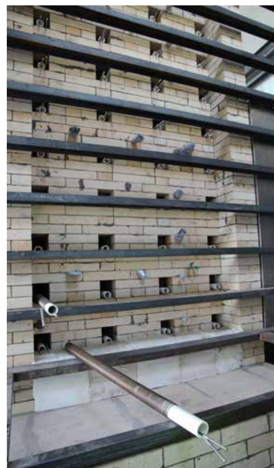
Im Hochtemperaturspeicher erzeugen elektrische Heizelemente aus Strom Wärme, die von Keramikelementen gespeichert wird.
