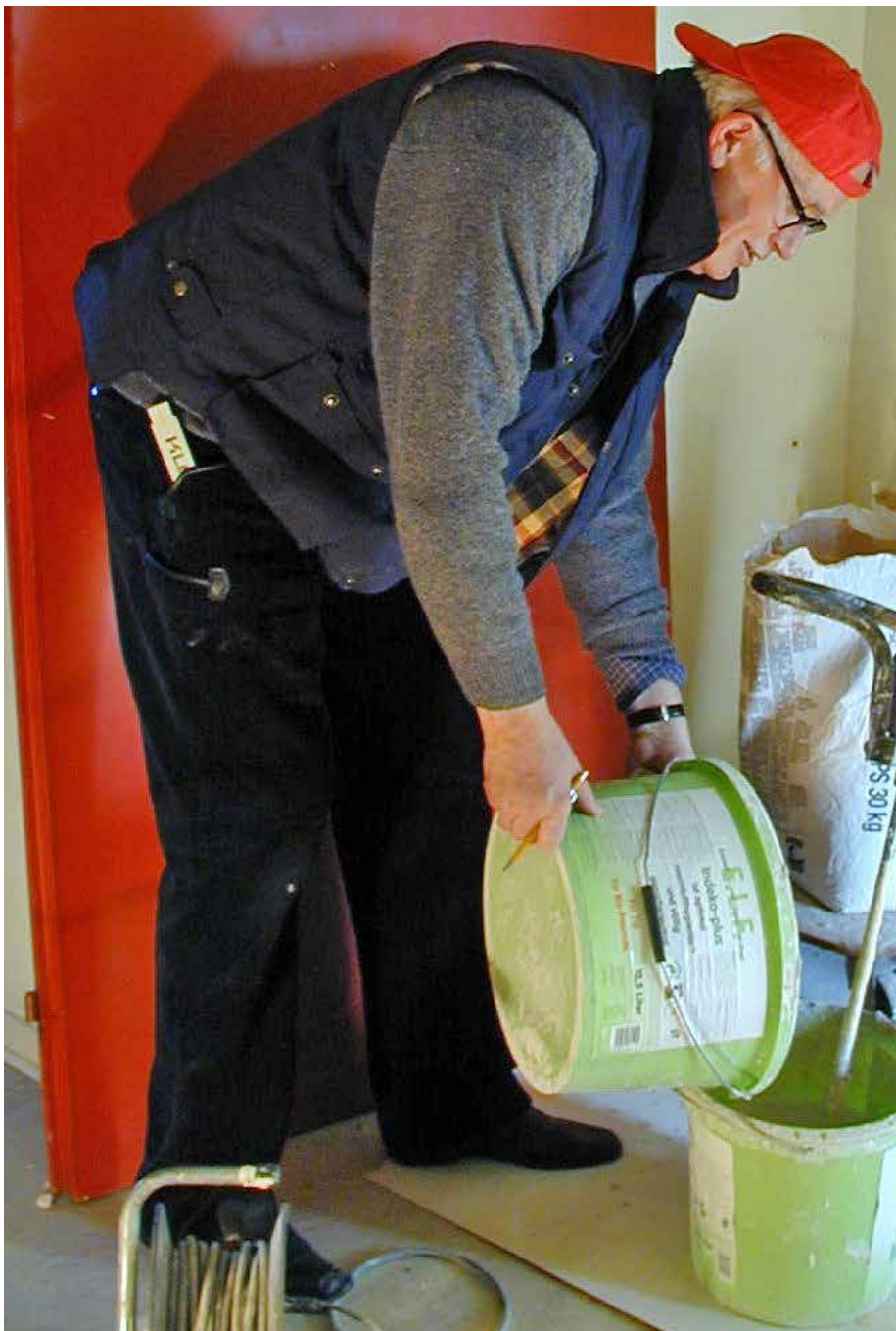
Bauten planen und leiten konnte Herbert von Wehrden meisterhaft. Und als die Aufgabe anstand, das Hugo-von-Ritgen-Haus für den Hochschulbetrieb umzubauen, packte er selbst mit an.
