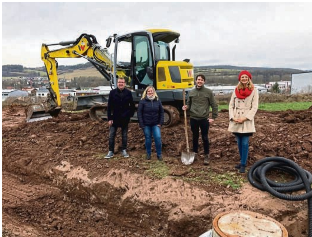
Hier soll der neue Produktionsstandort des derzeit in Eiterfeld ansässigen Unternehmens GN Schweißtechnik entstehen. Beim Spatenstich (von rechts): Geisas Bürgermeisterin Manuela Henkel, Creative-Space-Geschäftsführer Sandro Neumann, Geisas Zweite Beigeordnete Simone Kleinstück und der Erste Beigeordnete Steffen Bott.
