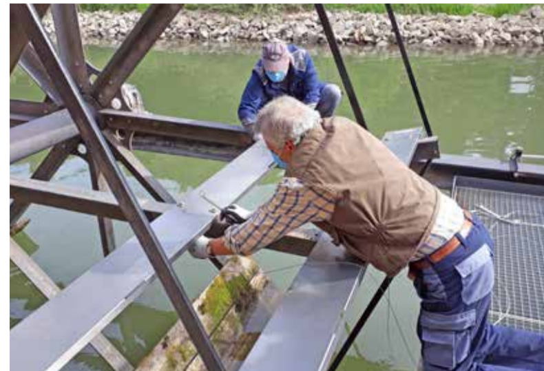
Die Mitglieder Manfred Büttner und Norbert Kuhnt bei den Arbeiten an den Wasserrädern.
