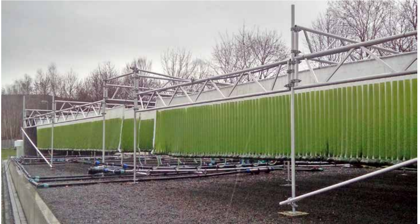
An Alugestänge sind in der Kläranlage Rotenburg die Beutel mit den Mikroalgen installiert.
