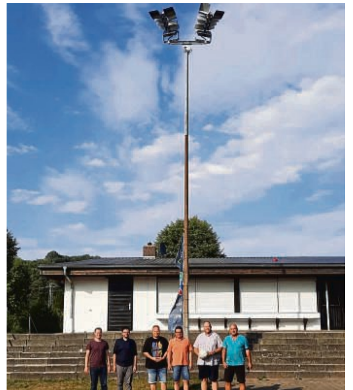
Erleuchtet in Ludwigsau: Die neue LED-Flutlichtanlage auf dem Sportplatz in Meckbach.
