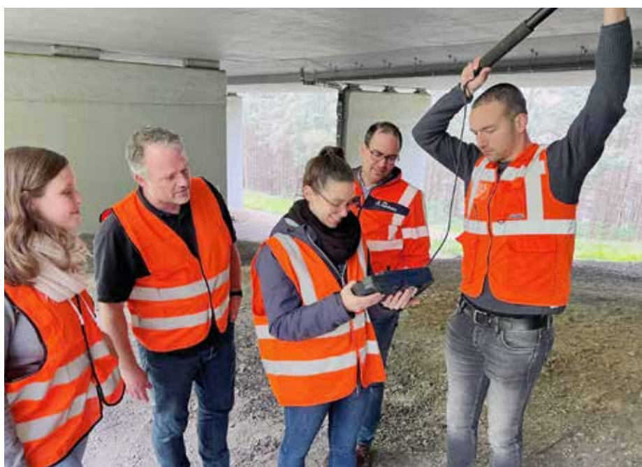
Mit einem Endoskop nehmen die Studierenden – begleitet von Prof. Bertram Kühn (2. v. l.) und Samuel Freund (Autobahn Westfalen, 2. v. r.) – die Hangbrücke Haiger unter die Lupe.
