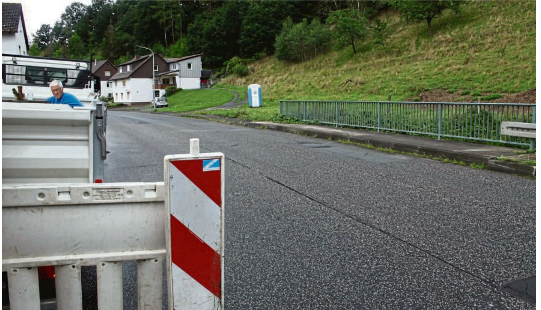
Baustelleneinrichtung in der Kasseler Straße in Ronshausen. Hier wird ab sofort gebaut, um die Brücke über die Ulfe zu sanieren.
