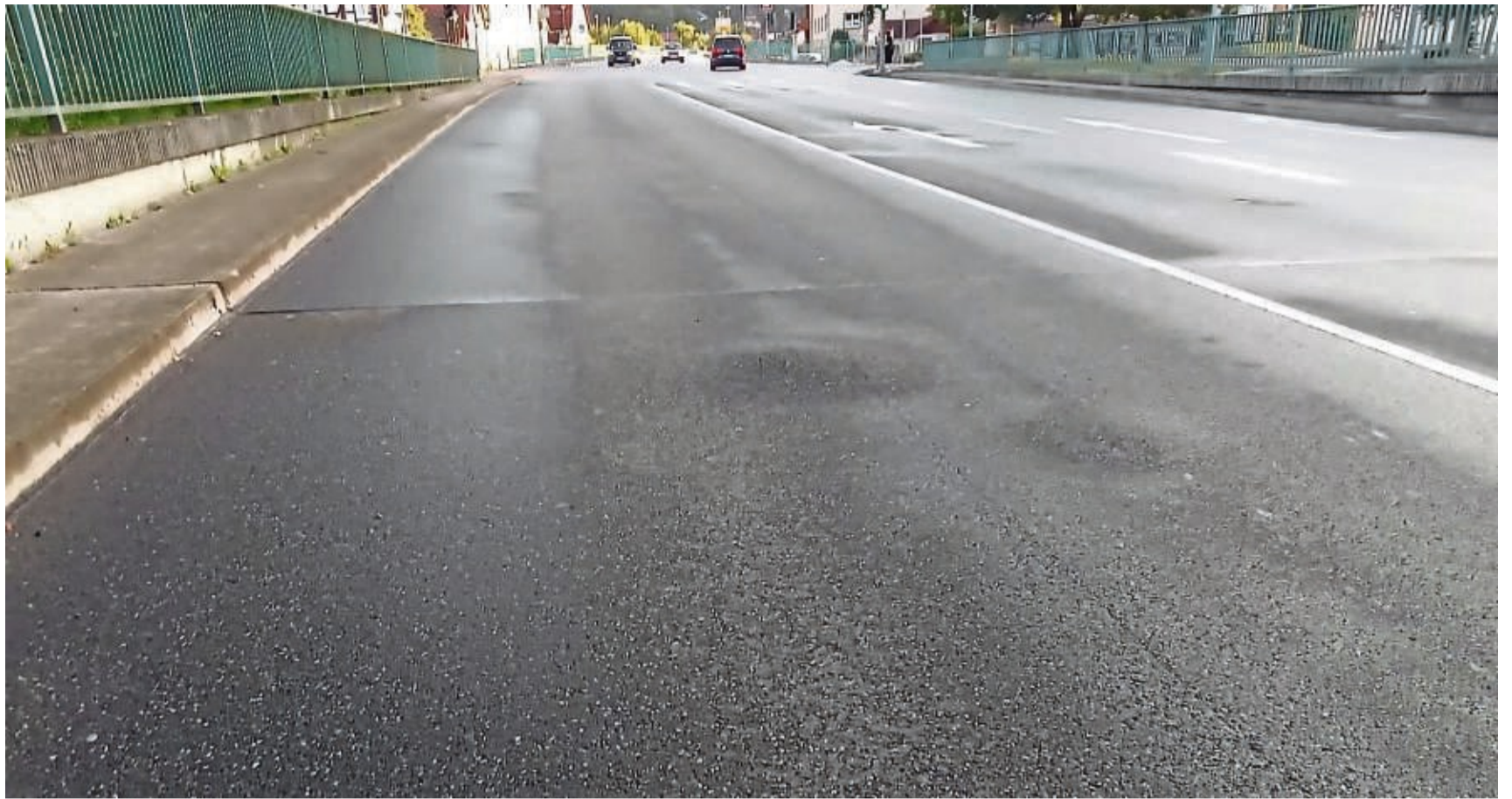
Noch sind sie da, die Blasen im Asphalt auf der Straße Brücke der Städtepartnerschaften in Rotenburg. Auf Fehler bei den Bauarbeiten sind sie nicht zurückzuführen, hat Hessen Mobil herausgefunden.
