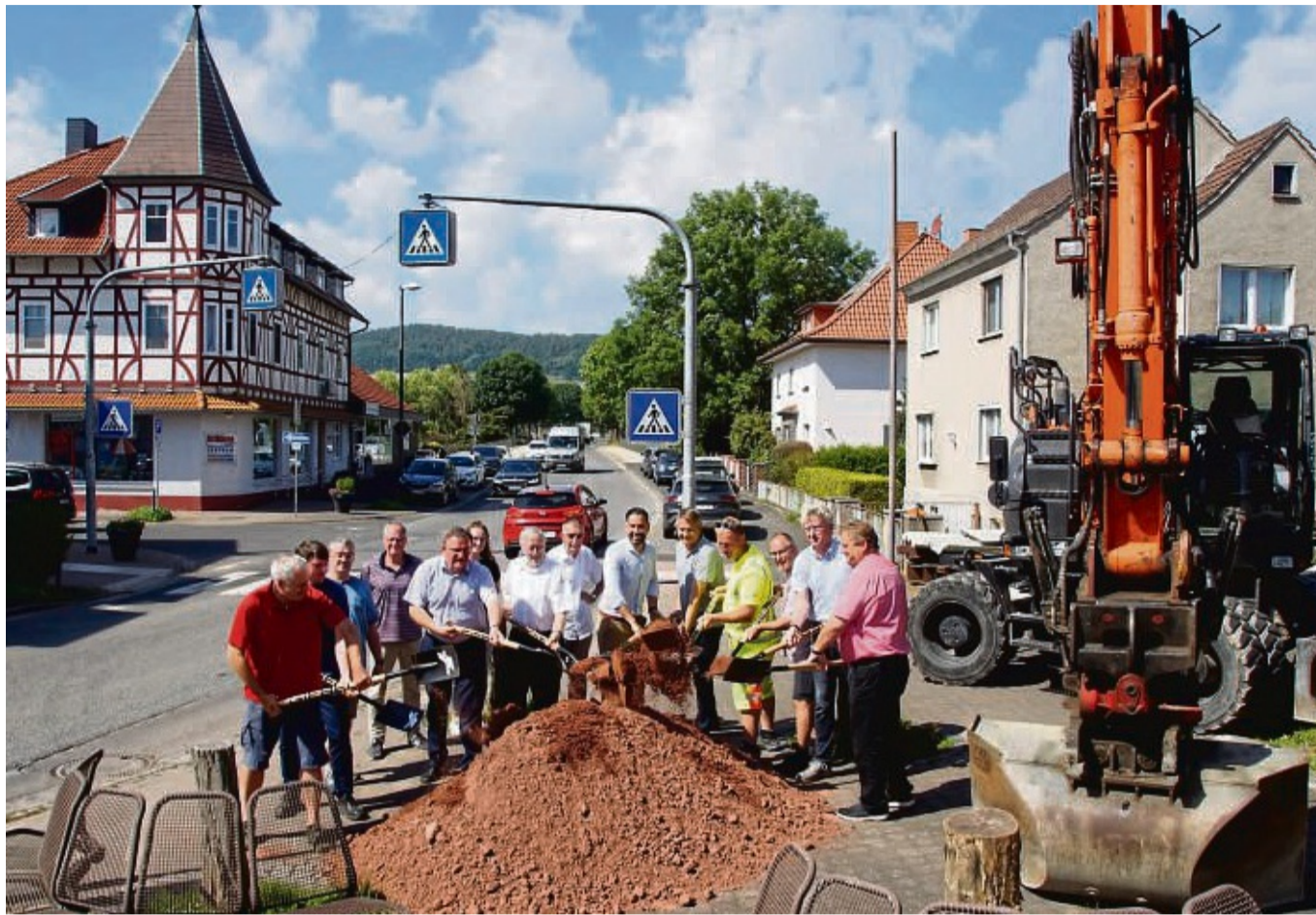
Symbolischer Akt: Vertreter von Stadt, Hessen Mobil sowie beteiligten Firmen und Planungsbüros beim Spatenstich für den Straßen- und Kanalbau auf dem Friedrich-Ebert-Platz und der Pfarrstraße.
