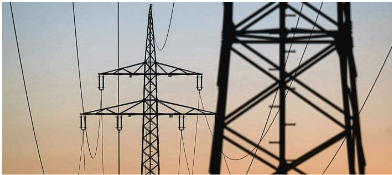
Alle wollen Strom, aber keine die Trassen: Auch im Kreis Hersfeld-Rotenburg sind zwei neue Stromleitungen geplant, die die Region von Nord nach Süd durchschneiden. FOTO: DPA
