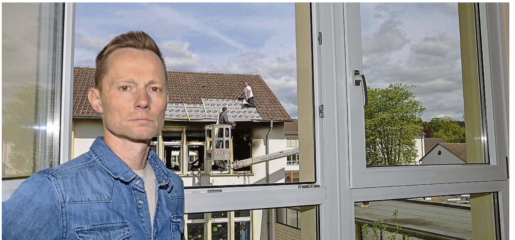
Hat nach dem Brand viel zu tun: Schulleiter Eckardt Bick. Am vom Feuer betroffenen Gebäude der Rotenburger Albert-Schweitzer-Schule – im Hintergrund ist das ausgebrannte Klassenzimmer zu sehen – haben bereits die Sicherungsarbeiten für das Dach begonnen. FOTOS: PGO
