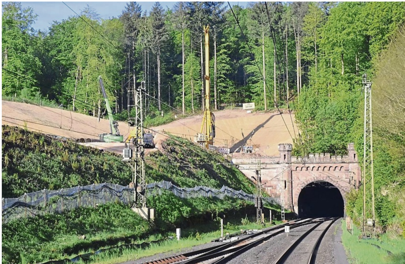
Die aufwendig gestalteten Portale des Cornberger Tunnels bleiben auch beim Neubau erhalten. Unser Foto zeigt den Blick auf die Baustelle aus Fahrtrichtung Eschwege. FOTO: PATRICK REHN/WH
