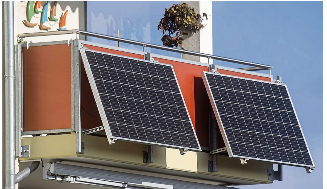
Die Stadt Bad Hersfeld fördert ab sofort wieder PV-Anlagen, sogenannte Balkonkraftwerke.
