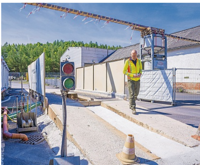
Die Lkw-Waschanlage gegen Arsen-Staub und Schlacke neben der Halde kommt nur selten zum Einsatz.
