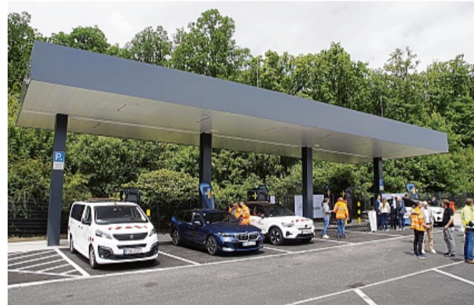
Überdacht und barrierefrei: Der Schnellladepark auf dem A4-Parkplatz-Seulingswald umfasst drei Ladesäulen mit je zwei Anschlüssen. FOTOS: JAN-CHRISTOPH EISENBERG
