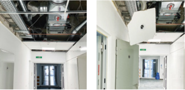
Achtung, Unfallgefahr: Ein Rohr samt Deckenplatte drohte herunterzufallen. Elena Berberich meldete diese unsichere Situation schnell und einfach über das Meldeformular im ISWnet. So konnte das Risiko umgehend beseitigt werden.
