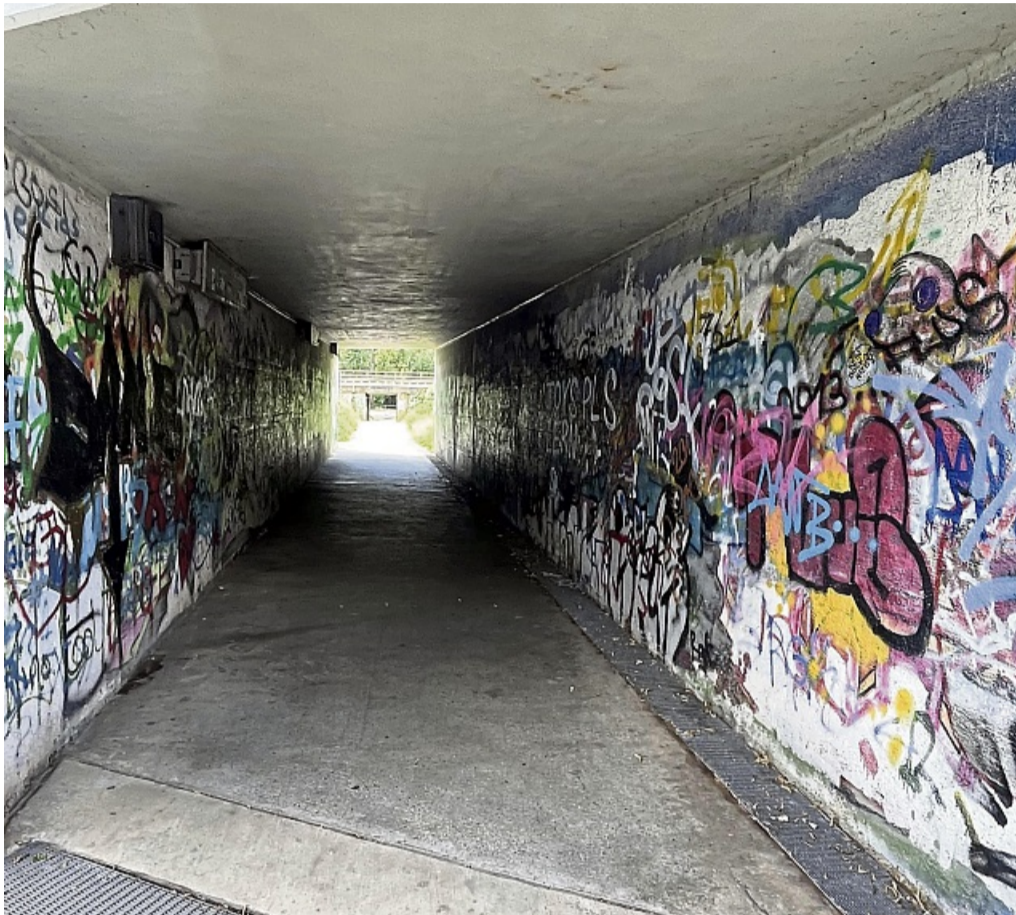
So sieht die Unterführung an der B83 derzeit aus: viel Grau, wildes Graffiti – bald soll hier ein gemeinsames Kunstwerk entstehen, das Rotenburgs Vielfalt sichtbar macht.
