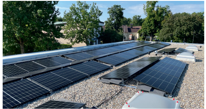
Die neue Photovoltaikanlage unserer Tagesförderstätte Aumühle
