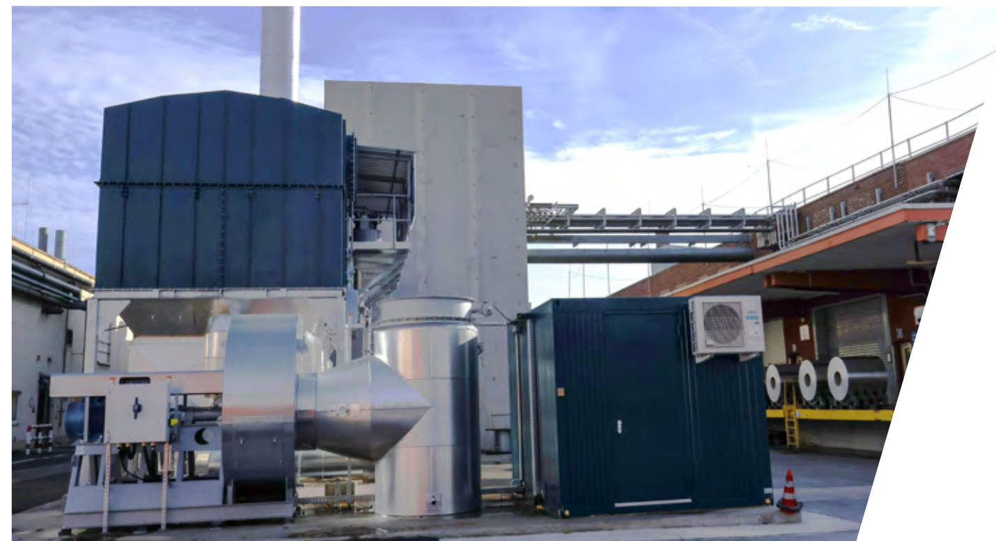
Die neue ECO3-RTO-Anlage Anfang November 2025.
