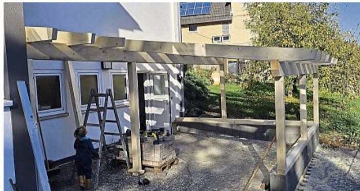
Schuffen fürs Vordach: Die Ehrenamtlichen in Sterkelshausen haben zusammen mit Baufirmen einen Freisitz vor dem Jugendraum aufgebaut.
