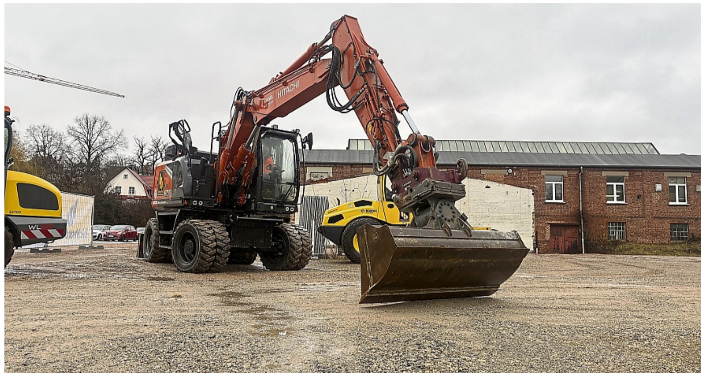
Den Bagger in Bewegung setzte Schachtmeister Uwe Seifert von Bickhardt Bau. Die weiße Fläche an der Wand des Gebäudes erinnert an eine abgerissene Halle der Firma Trox.
