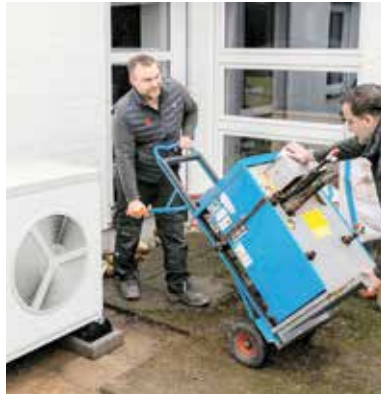
Alte Heizung raus, moderne Wärmepumpe rein: Dieser Umstieg zahlt sich gleich mehrfach aus.
