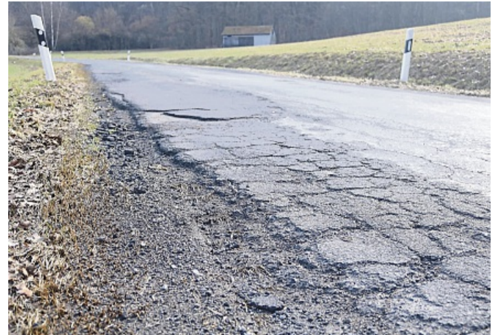
Brüchig und schmaler ist die Fahrbahn mit der starken Belastung geworden. Edith Semmler sagt, dass Anfang des Jahres Leitpfosten umgefallen waren.
