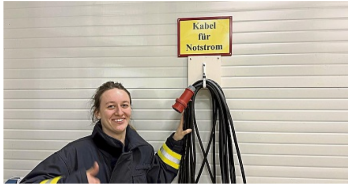
Bereit für den Ernstfall: Jessica Rauchhaus zeigt das Anschlusskabel für die Notstromversorgung. Im Stromausfall wird Technik zur Lebensader.
