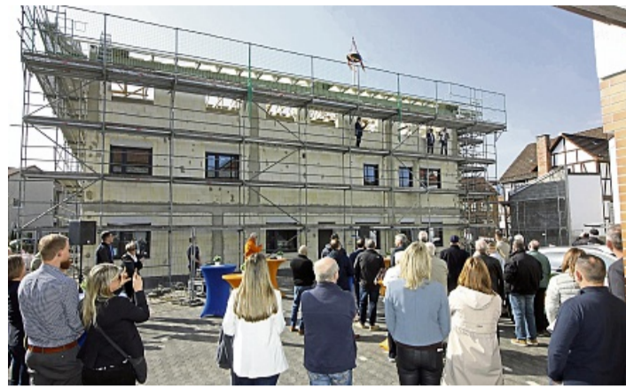
Besucherandrang am Rohbau: Zahlreiche Vertreter der Volksbank, von Unternehmen und aus den politischen Gremien nahmen am Richtfest für das neue Gesundheitszentrum Friedewald teil. FOTO: THOMAS KLEMM
