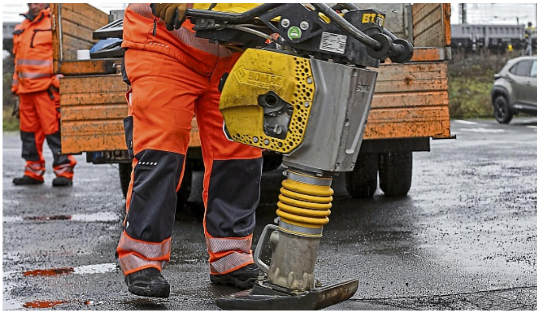
Als Folge des Frosts sind wieder zahlreiche Schlaglöcher entstanden. Der städtische Bauhof ist derzeit mit zwei Teams für Reparaturen unterwegs.
