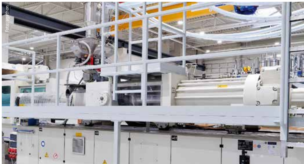
Dosiergeräte von Movacolor additivieren das Polycarbonat auf der Spritzgießmaschine gravimetrisch mit mehreren Masterbatch-Komponenten.
