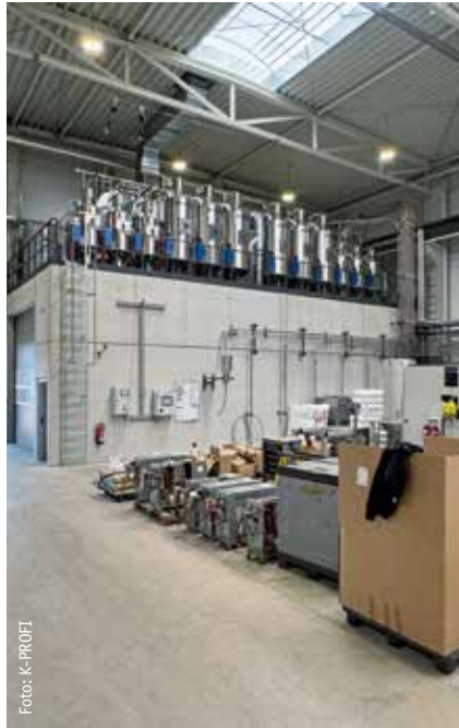
Die zentrale Materialversorgung mit zwölf Trocknungstrichtern ist auf einer Betonbühne installiert und versorgt sich über die Außensilos oder über Big-Bag-Entleerungsstationen unter der Bühne.
