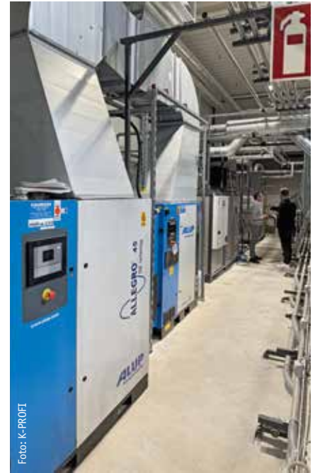
Blick hinter die Trocknungstrichter: Zwei wassergekühlte Druckluftkompressoren (vorne in Blau) geben die Wärme wenige Meter weiter an die Wasser-Wärmetauscher der Trockenluftheizer (hinten) ab.
