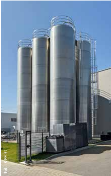
Sechs nagelneue Silos von Siloanlagen Achberg mit einem Fassungsvermögen von jeweils 78 m 3 versorgen die von Labotek installierten Trockner auf kürzestem Weg mit Polycarbonat.
