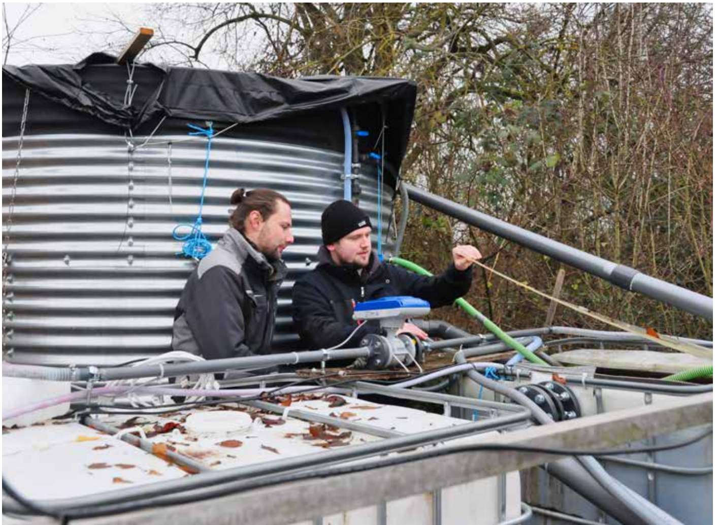
In der Kläranlage in Lollar hat das Forschungsteam die Notfallkläranlage aufgebaut. Die Studenten Nicolas Jost (li.) und Louis Müller überprüfen, ob alles funktioniert.
