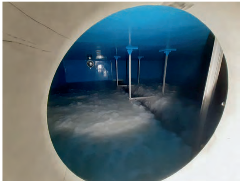
Links: ausgebaute, korrodierte Klappe Rechts: Klarspülen des frisch eingebrachten Sandes in Filter 1
