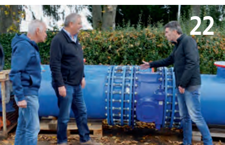
Die Stadt Kelkheim sichert zusammen mit Hessenwasser die Versorgung über einen Bypass.
