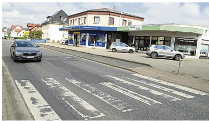
Immer schlechter erkennbar, teilweise mit Flick-Asphalt überdeckt: Der wegen der vielen Geschäfte stark benutzte Zebrastreifen an der Einmündung Posener Straße.
