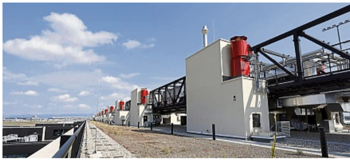
Ventilatoren der Firma Trox auf dem Dach des neuen Terminal 3 am Frankfurter Flughafen. FOTO: TROX/MEINHARDT ANDREAS/NH
