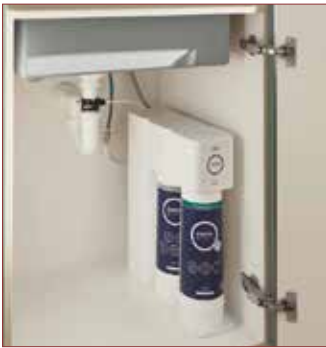
DER GROHE WASSERFILTER ist ordentlich unter der Spüle integriert.
