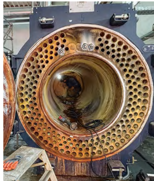
Inspektion der defekten BARA-Heizanlage, an der wiederholt Rohrleckagen auftraten.
