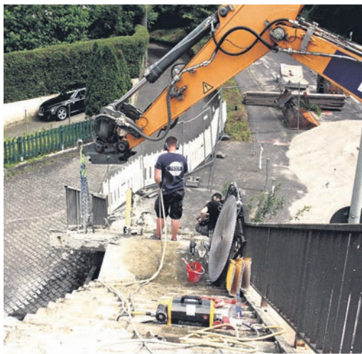
Am Dienstagnachmittag fehlte schon ein Stück vom Treppenaufgang der Brücke. Foto: EZ
