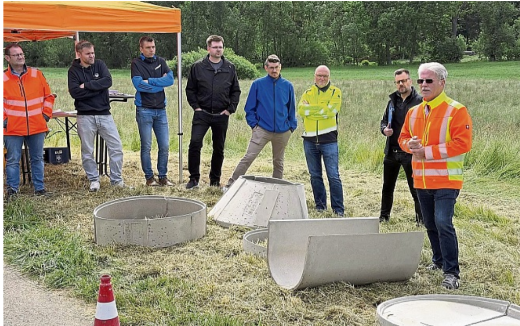
Schachtsanierung mit Polymerbeton: Das Ingenieurbüro Gröticke und die Firma Wienerberger führten in Berndorf vor, wie korrodierte Kanalschächte kostengünstig saniert werden können.
