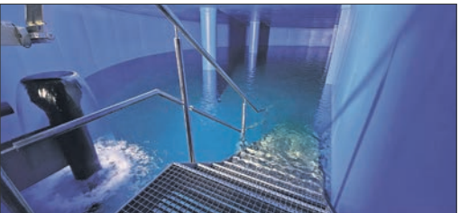
In kühles Blau getaucht ist der Hochbehälter Heinzberg. Foto: Stadt Eppstein
