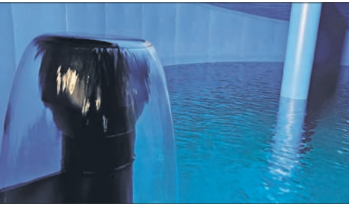
Blick in einen Wasserhochbehälter im Stadtgebiet von Eppstein. Foto: Stadt Eppstein
