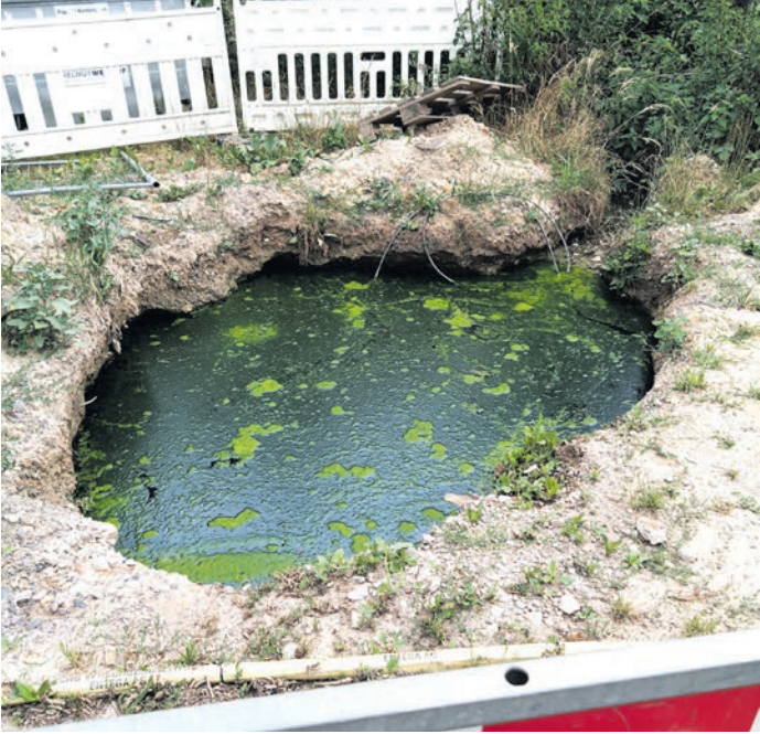
Durch private Baggerarbeiten wurde das Abflussrohr beschädigt. Bis zum Ende der Reparaturarbeiten bleibt die Gastronomie definitiv geschlossen. (Foto: micha)
