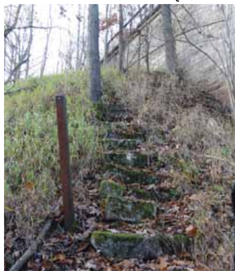
Die Reste der ehemaligen Diensttreppe, die an der Südseite des Dammes nach oben führt
