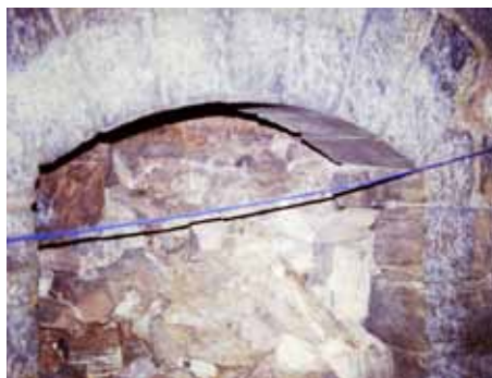
Eine mit Gesteinsbrocken aus der Tunneldecke gefüllte Tunnelnische Foto: Schleicher
