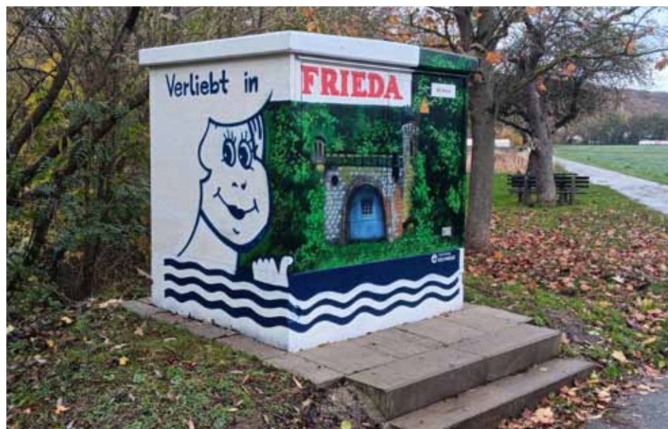
Prunkstück der tollen Kunstwerke ist die Trafostation am Radweg zwischen Frieda und Wanfried.
