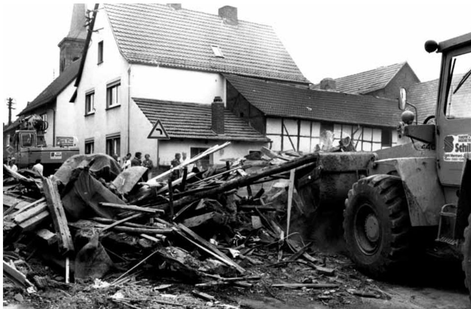
Bis in die Abendstunden dauerten die Aufräumarbeiten in der Leipziger Straße.
