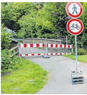
Die Rad- und Fußwegbrücke über den Bollerbach an der Lütmarser Straße ist gesperrt.
