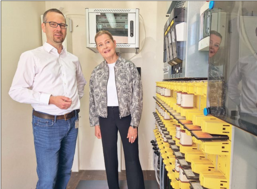
Prof. Florian Steinke von der TU Darmstadt und Ines Schultze (kaufmännische Vorständin e-netz Südhausen) begutachten einen Teil der technischen Ausstattung für das Projekt. Foto: ENTEGA AG
