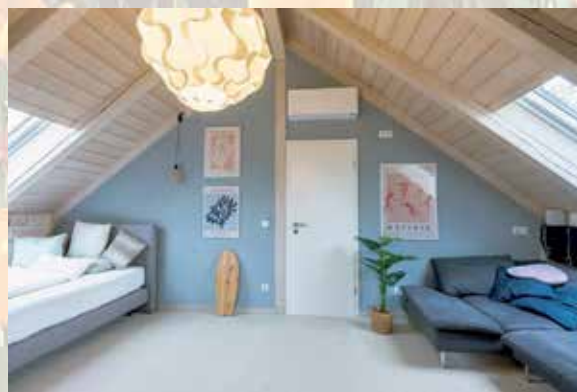
Gerade unterm Dach, wo sich oft die Sommerhitze staut, sind die Vorteile einer Luft-Luft-Wärmepumpe unmittelbar spürbar.
