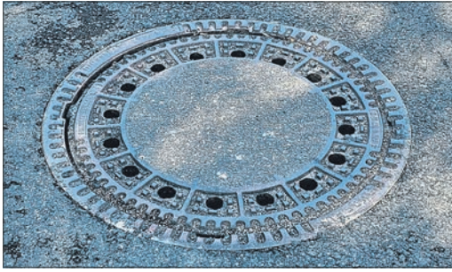
Auf der frisch sanierten Umgehungsstraße B 455 muss an den Kanalschächten nachgebessert werden.
