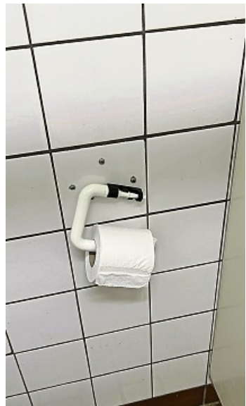
Beschädigungen in den Toilettenkabinen im Philippsthaler Schlosspark.
