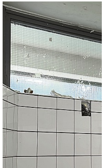
Verschmutzungen an den Fenstern der Toilettenanlage.
