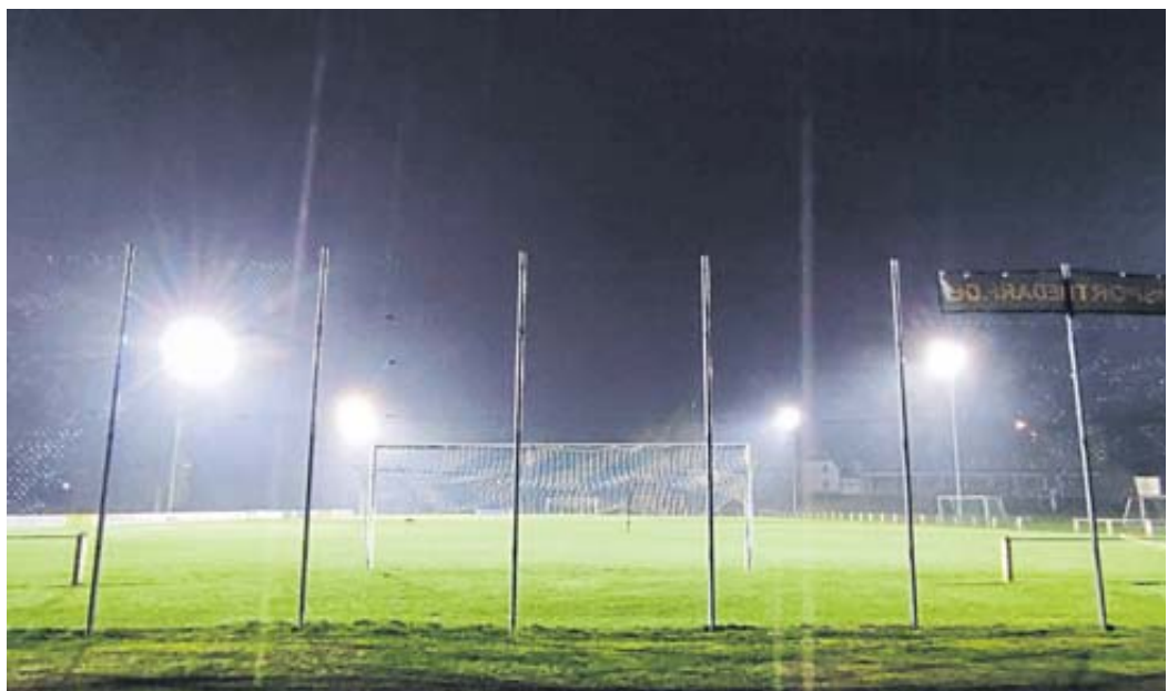
Die Flutlichtanlage wurde auf den neusten Stand der Technik gebracht und mit LED-Leuchten ausgestattet. Foto: privat
