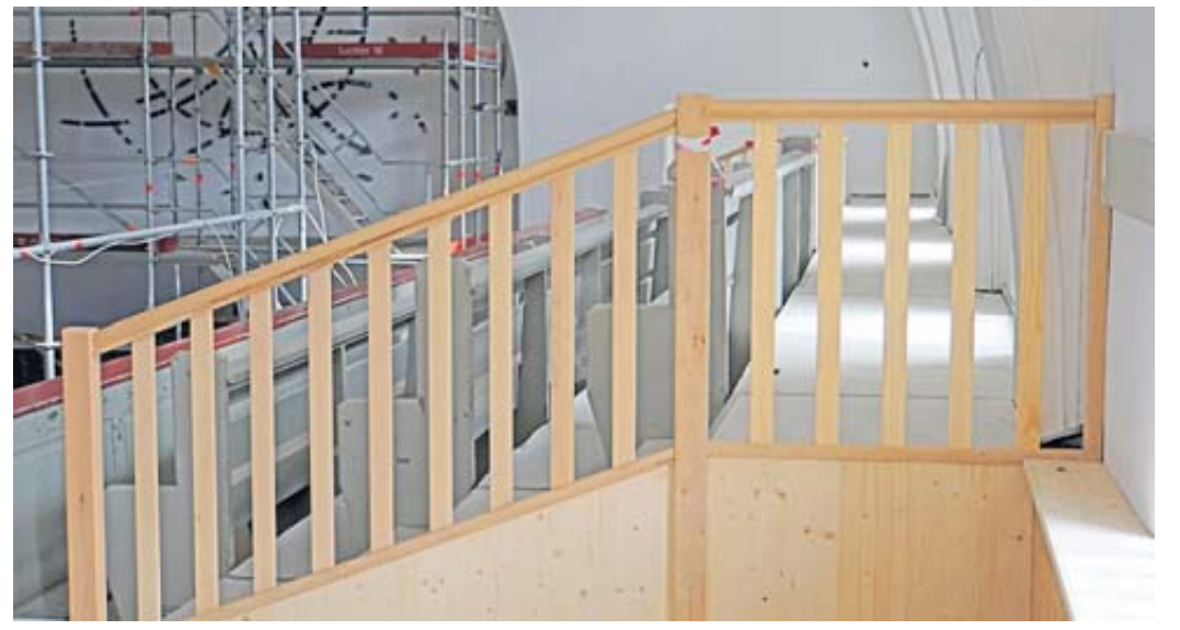
Trotz leichter Verzögerungen sind die Bauarbeiten gut vorangeschritten, hier ein Blick auf die Empore und das noch eingerüstete Glaskunstwerk. Fotos: Wilfried A. Battefeld
